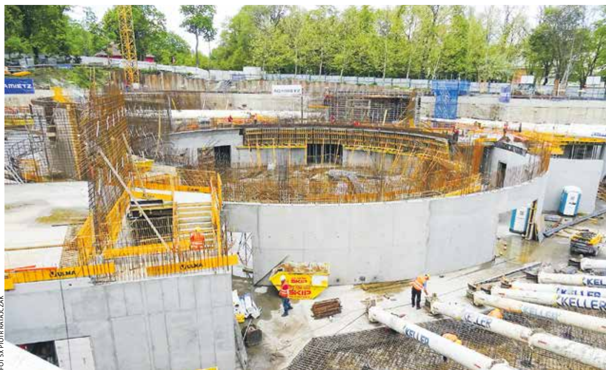
Prowadzone od roku roboty ziemne i prace związane z budową fundamentów (m.in. wbijanie pali i budowa betonowej niecki, które mają ustabilizować konstrukcję i uchronić muzeum przed zalewaniem wodami gruntowymi) kosztowały ponad 50 mln zł.
