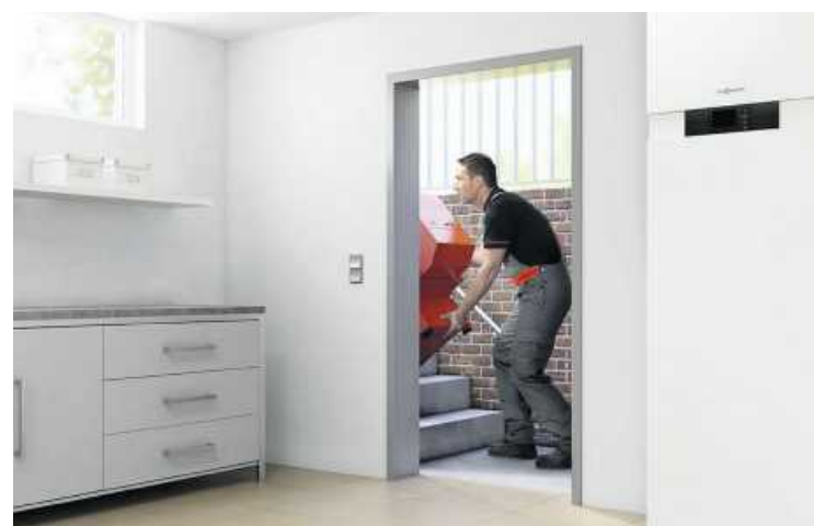
• Modernizacja przestarzałego systemu grzewczego jest nieodłącznym elementem każdej termomodernizacji budynku, niezależnie od jej zakresu FOT. MATERIAŁY PRASOWE
