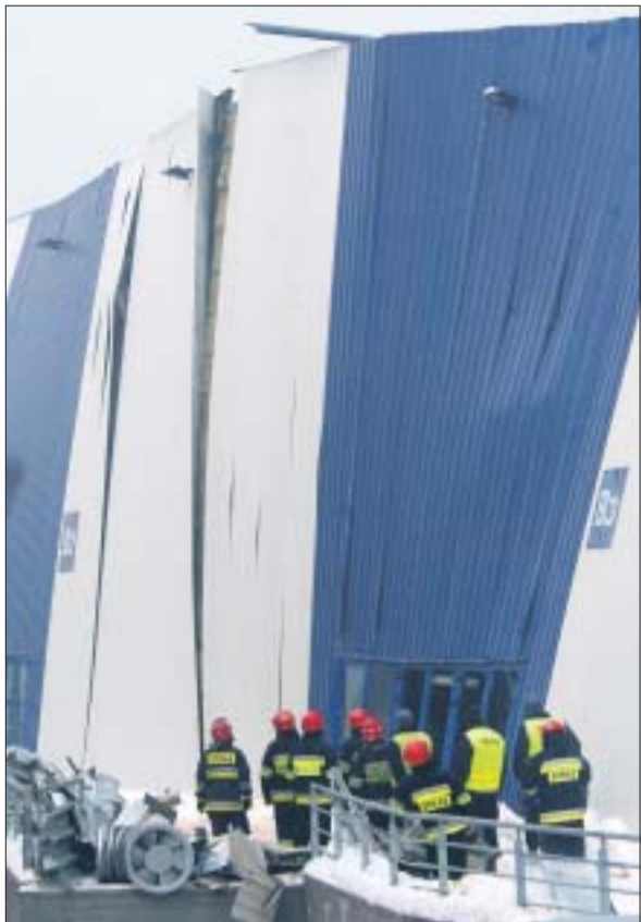
Niedziela rano. Ściany stoją, choć dachu już nie ma. Ratownicy wchodzą do środka hali, ale nikogo żywego już nie znajdują
